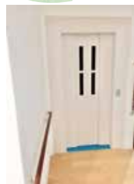
エレベーター
